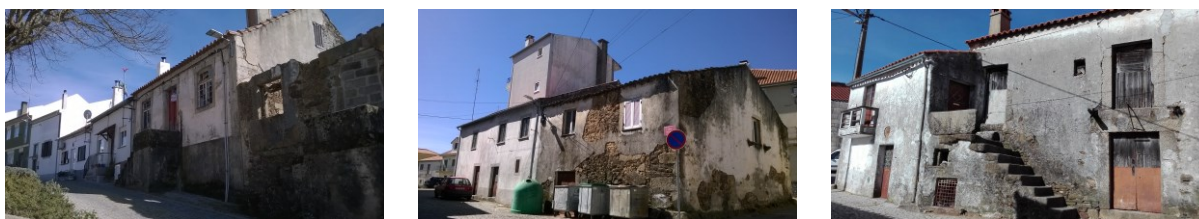
Figura 15. Exemplos de edifícios em estado crítico de conservação na ARU
