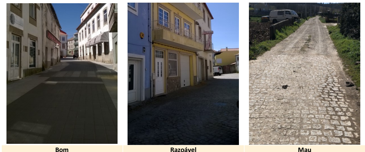
Figura 11. Exemplo do estado de conservação da rede viária (faixa de rodagem)
