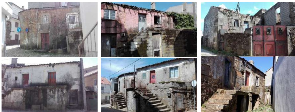
Figura 17. Exemplos de edifícios em estado crítico de conservação na ARU
