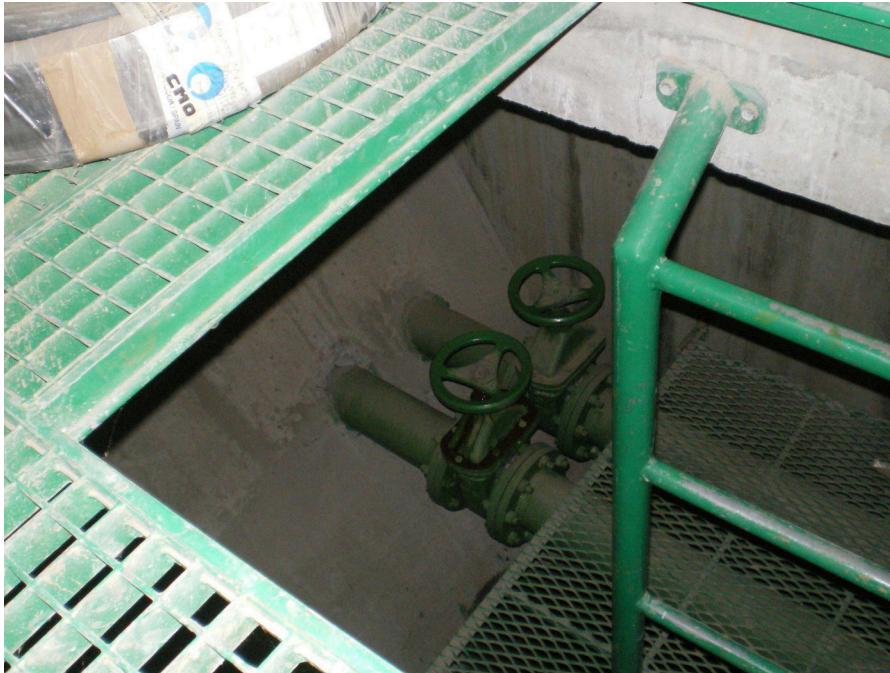
Fotografia 2 – Válvulas de controlo da descarga de caudal ecológico, situadas na câmara de válvulas.
